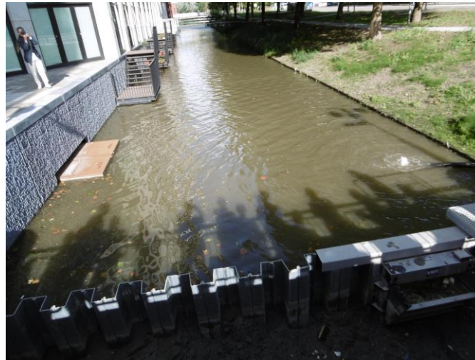
河川水の取水口 熱は集合住宅で 利用
