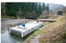
小水力発電施設
